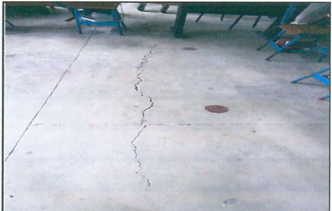
Foto 4: El Piso de los Salones de clase esta grietado.
