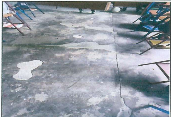
Foto 2: Piso de los salones de clases en malas condiciones
