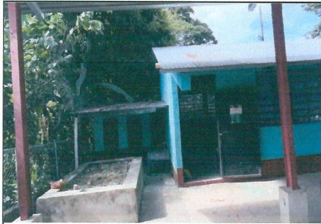
Foto 1: Lámina del establecimiento no es la adecuada y ya está con óxido
